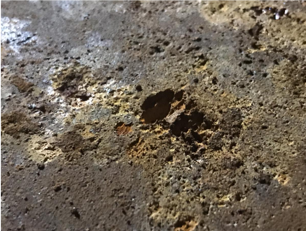
Mynd 3. Gólf er alsett minniháttar tæringu og á einstaka stað mátti finna 3-4mm djúpa pytti.
