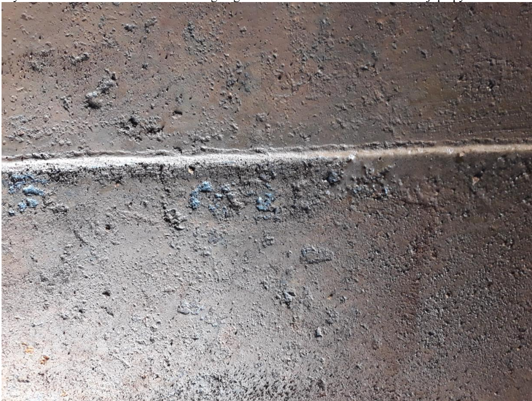
Mynd 4. Gólf er alsett minniháttar tæringu og á einstaka stað mátti finna 3-4mm djúpa pytti.
