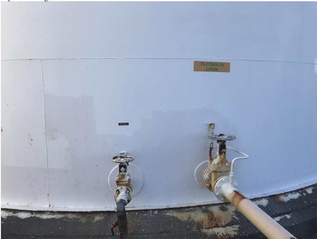
Mynd 6. Geymir lítur vel út að utan en þó má sjá á einstaka stað litlar ryðbólur.
